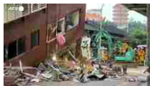
Terremoto a Taiwan, danni e macerie vicino all'epicentro nella contea Hualien
